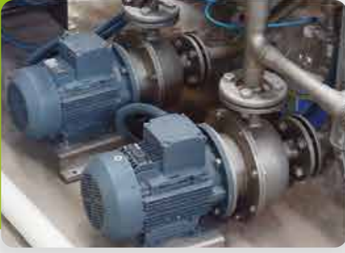
DOZAJLAMA POMPASI DOSING PUMP
