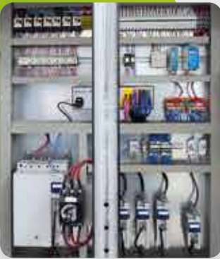
ELEKTRİK PANOSU ELECTRICAL PANEL
